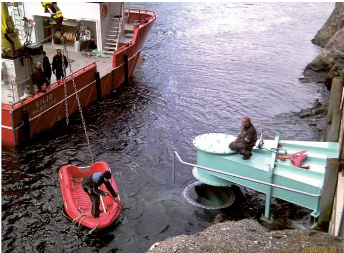
Montering av ny oppstrømningsstasjon i Lysefjorden. The new upwelling facility in Lysefjorden.
